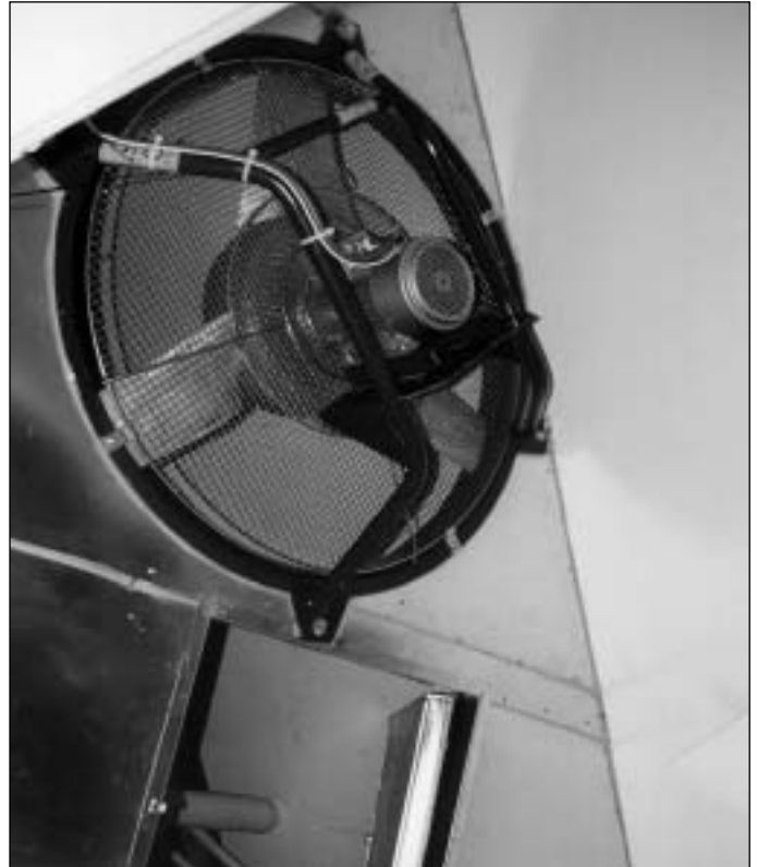
FIGUUR 3: INWENDIG AANZICHT VAN DE AFVOER-SCHOORSTEEN MET VENTILATOR
